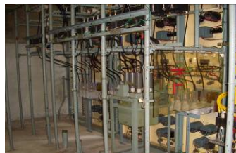
老朽化した受変電設備
