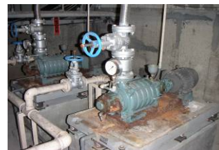
老朽化したポンプ
