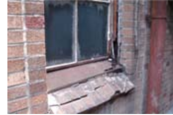
今にも落下しそうな外壁
