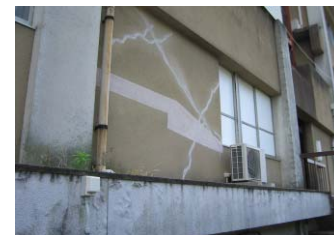
外壁クラック
