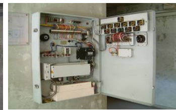
老朽化した自動火災報知器
