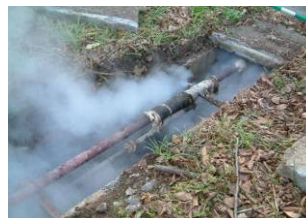
屋外蒸気管の漏れ
