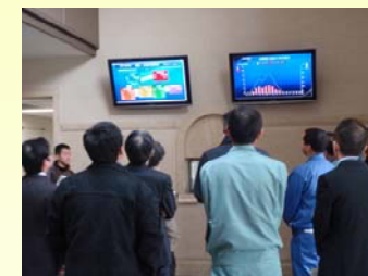
「太陽光発電量」と「使用量の見える化」が大型ディスプレイで確認できる（玄関ホール）
