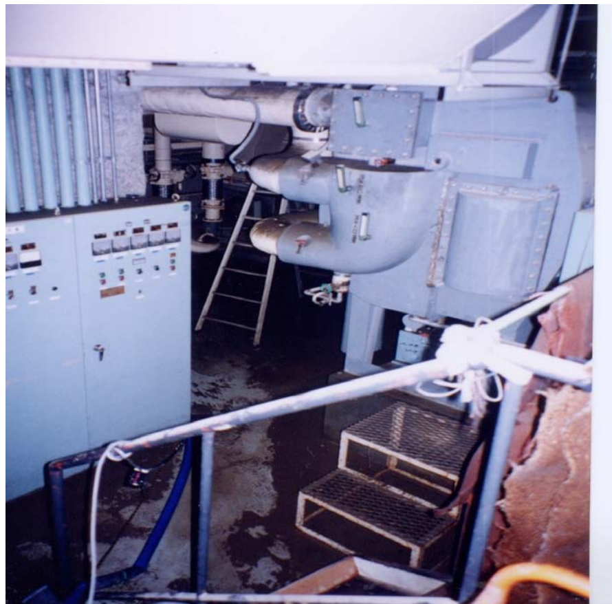
機械室天井まで水没
