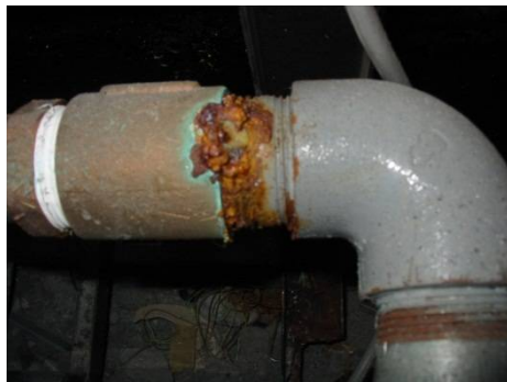
給水管継ぎ手の劣化状況
