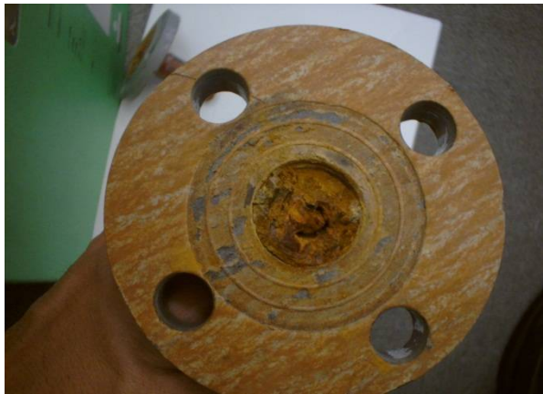
建築後10数年の給排水管の閉塞状況
