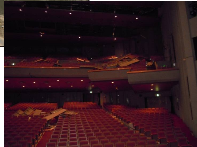
(3.11福島県民ホール天井落下)
