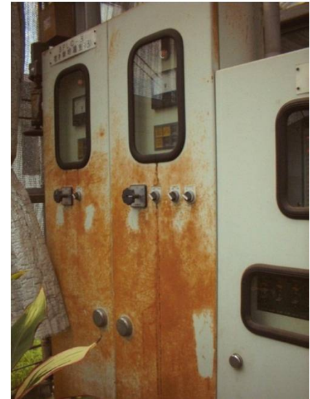
変電設備の発錆、浸水
