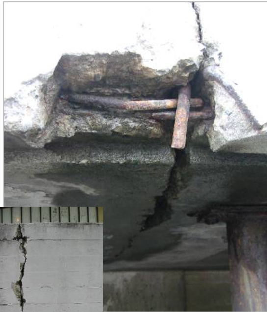
コンクリートの爆裂
