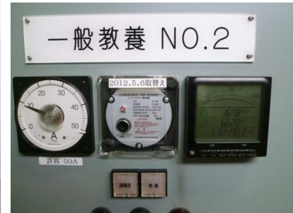
新設スマートメーター
