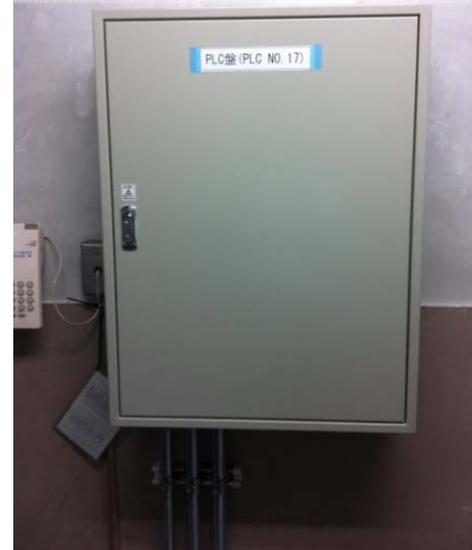
データ収集コントローラ盤
