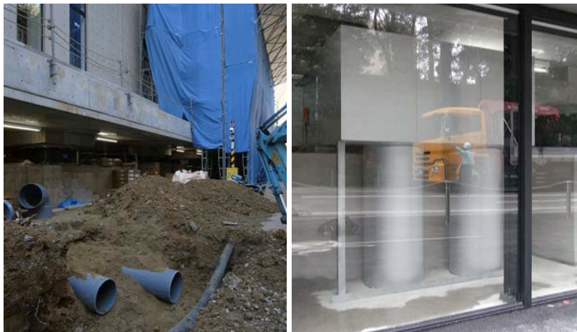
ピット階・免震ギャラリー：既設共同溝を活用したアースチューブ→1階床に配管。
