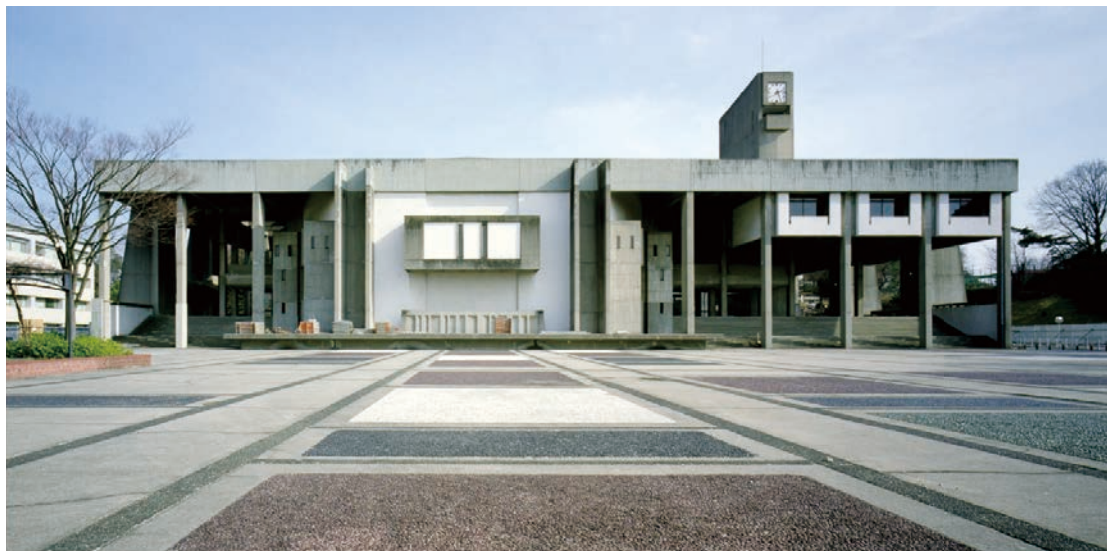
改修前 打放面の風化・汚染，塗膜による改修履歴あり，前庭コンクリート舗装の劣化
